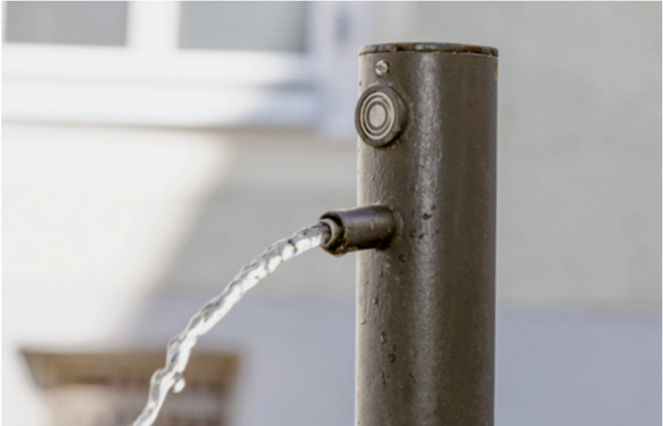
Abb. 6 Trinkwasserbrunnen. Quelle: Stadt Regensburg, Bilddokumentation
