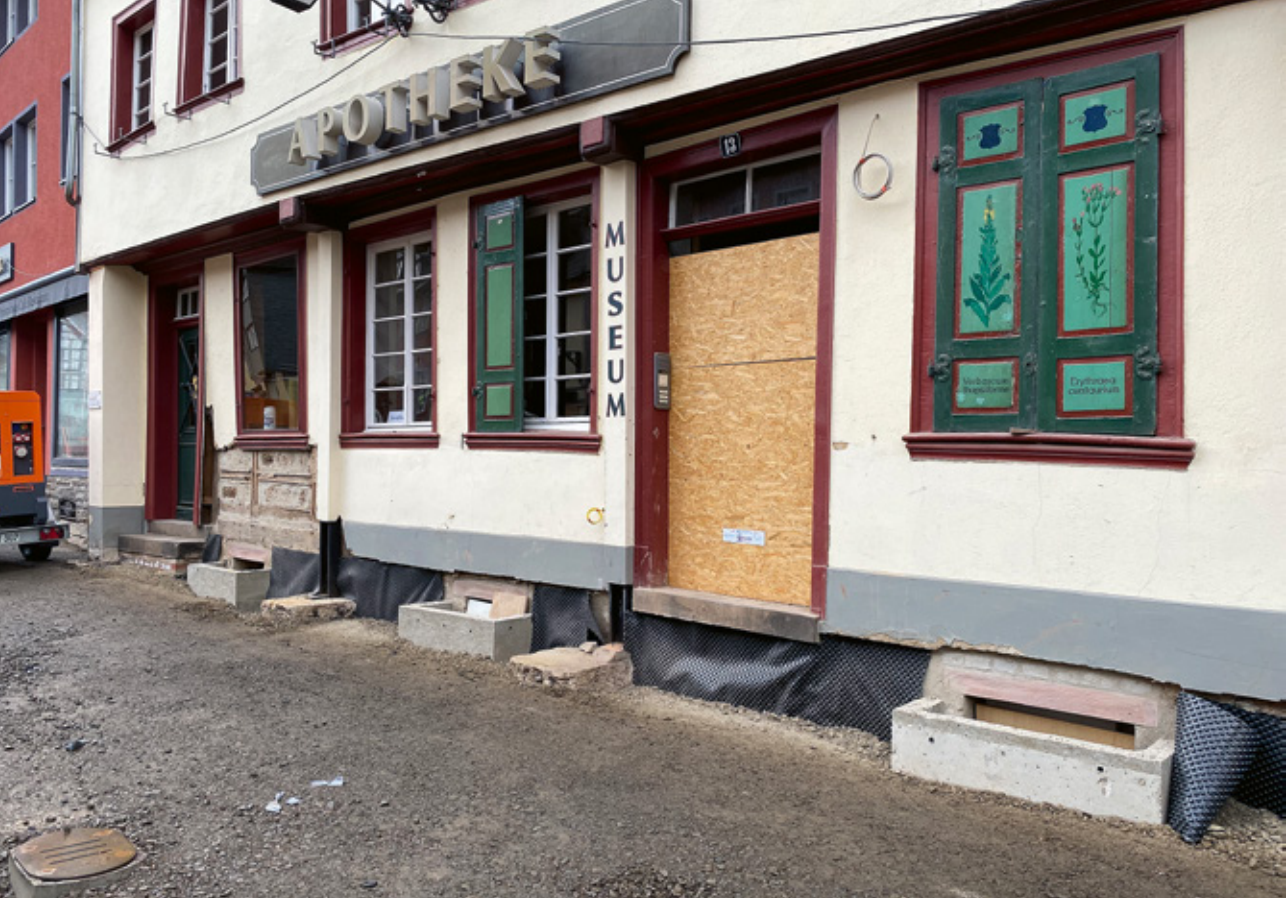
Abb. 2 Eine gezielte Wiederherstellung bauzeitlicher Kelleröffnungen zur besseren Belüftung sowie für einen besseren Wasserdurchfluss im Falle eines erneuten Hochwassers; © Bastian Wahler-Zak
